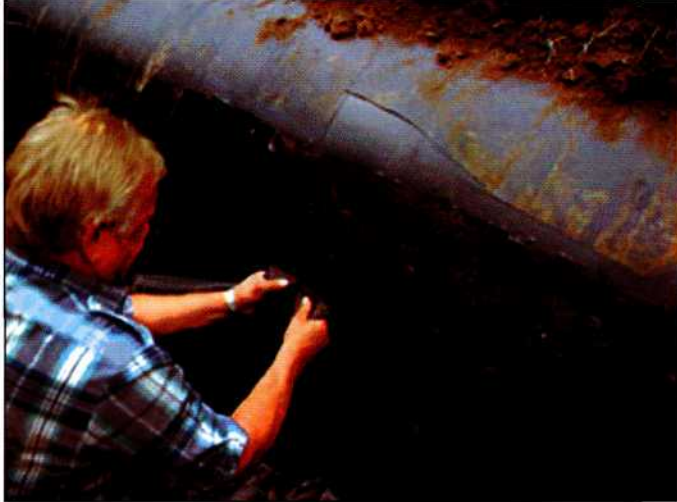
Рис. 32. Коррозия металла — большая опасность для трубопроводов
